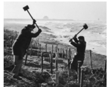
Vor dem nächsten Hochwasser muss der Deich provisorisch gesichert werden (Foto: Reimer und Wiebke Busch)
